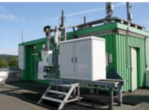
Brandstofcellen als noodstroomvoorziening vormen een alternatief voor accu's of dieselgeneratoren.
